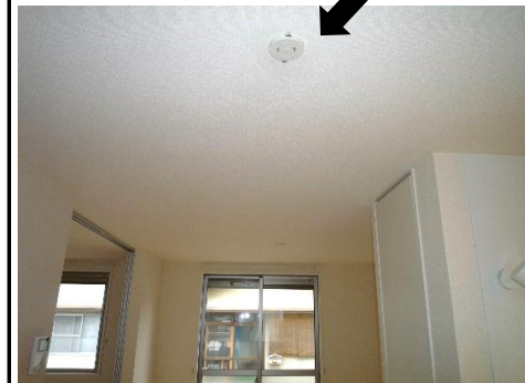
LDKの照明器具設置箇所
