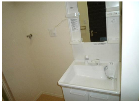
洗面台・洗濯機置場
