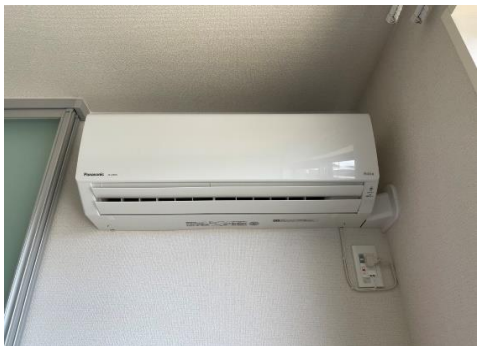
西側 洋室 エアコン
