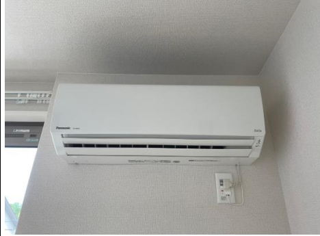
東側 洋室 エアコン
